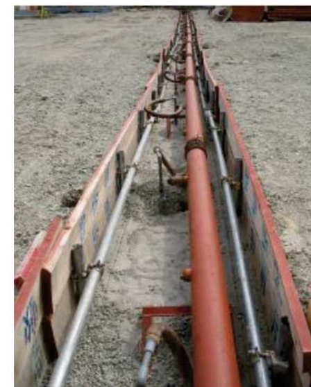
井戸設置例(未供用地)
