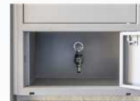
⑤ 非常用散水栓
