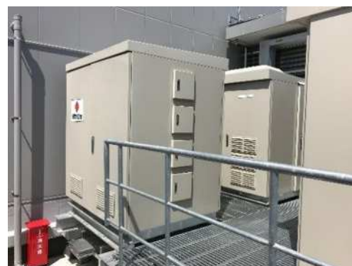
(左) リユース蓄電池盤 (右) PCS盤
