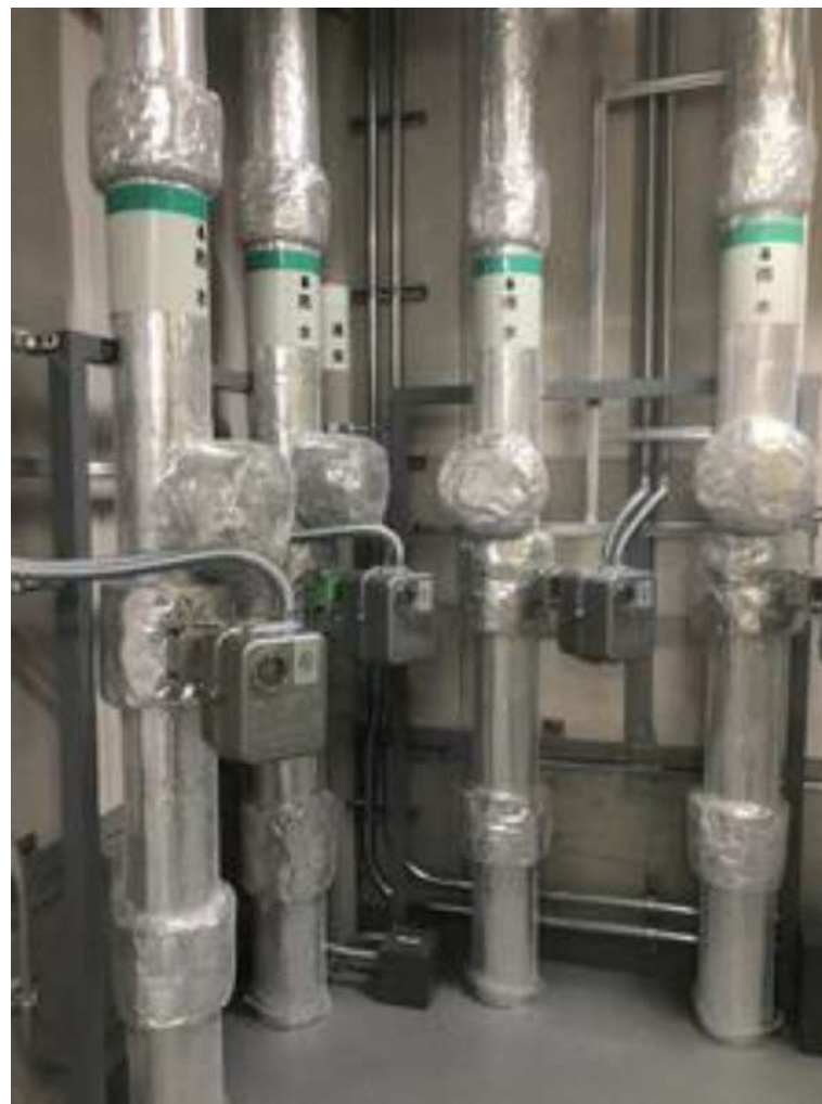
雨水配管と雨水緊急遮断弁
