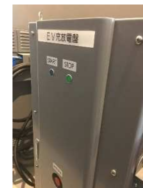
EV充放電器盤
