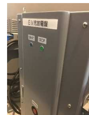
EV充放電器盤
