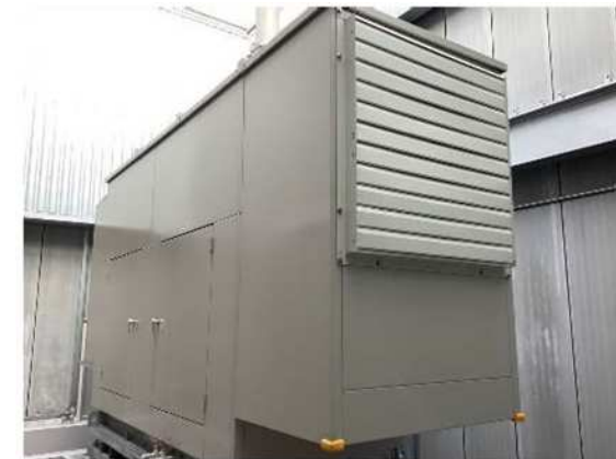
非常用発電機
