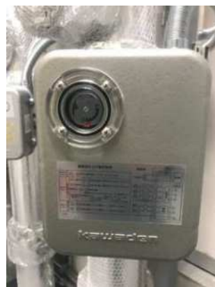
雨水緊急遮断弁
