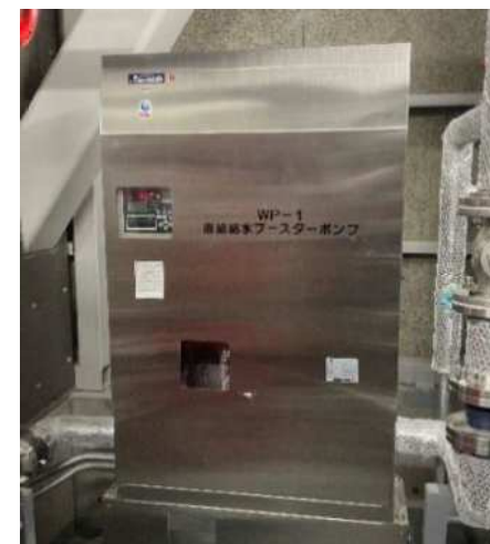
停電時に直圧給水可能な直結増圧ポンプ ※ポンプが水没した場合は使用不可
