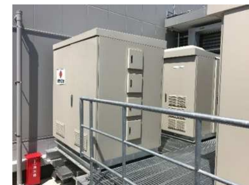
(左) リユース蓄電池盤 (右) PCS盤
