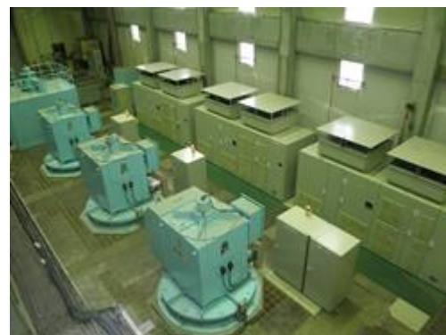
電動機、インバータ制御装置
