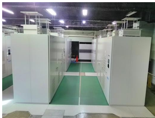
図 2 送水ポンプ用インバータ装置
