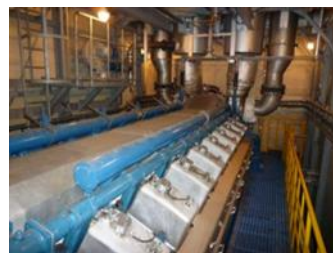
ガスエンジンCGS
