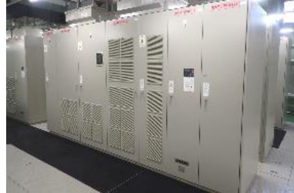
図 1 送水ポンプ用インバータ装置
