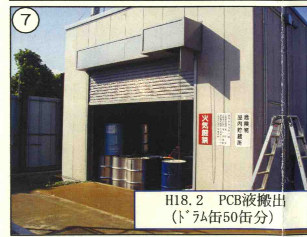
PCB液保管庫（土壤浄化施設内）
