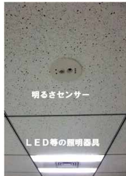
<ビル内のLED照明採用事例>
