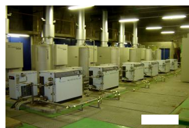
【マイクロガスタービン発電機】
