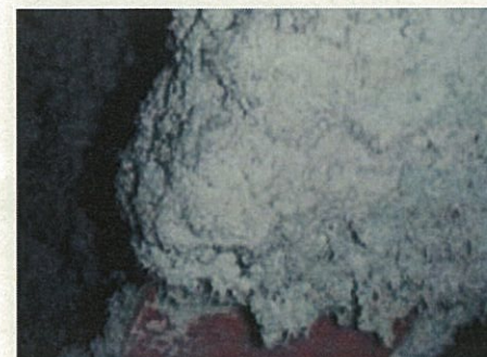
【吹付石綿の例】
