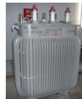
【トランス（高濃度PCB廃棄物）】
