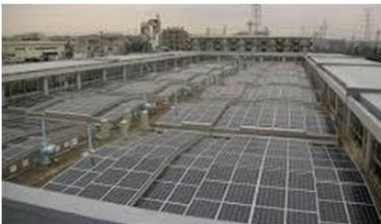
導入例：東村山浄水場 発電容量：2,033kW
