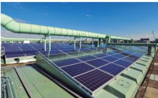
導入例：森ヶ崎水再生センター 発電容量：1,000kW
