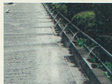
＜保水性舗装・散水設備＞
