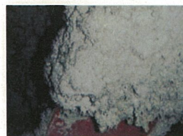
【吹付石綿の例】
