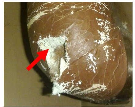
保温材の露出
