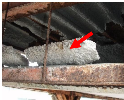
落下した吹付け材
