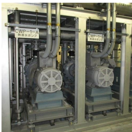
[インバータ化した空調用ポンプ]
