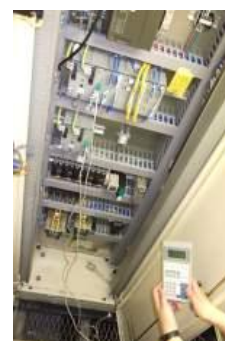
空調機ファン インバータ調整
