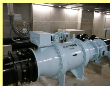
小水力発電設備 (南千住給水所)
