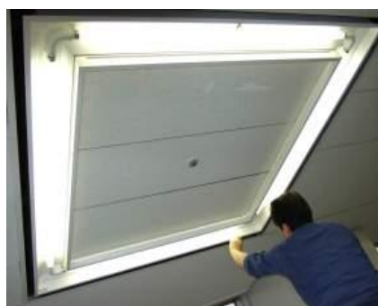
執務室空調吹出口
