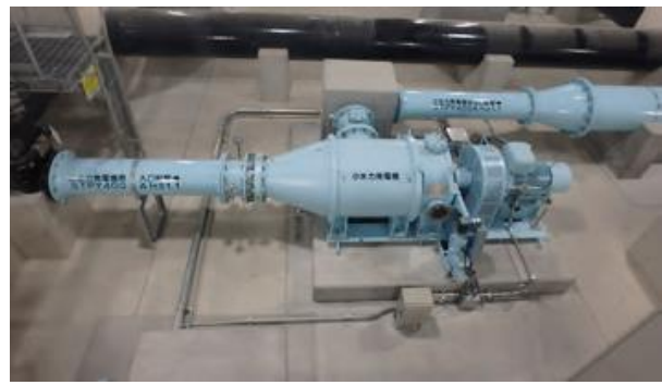
小水力発電設備
