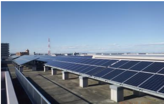
太陽光発電設備
