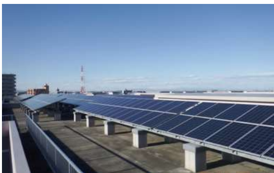
太陽光発電設備
