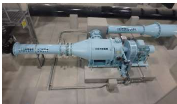
小水力発電設備
