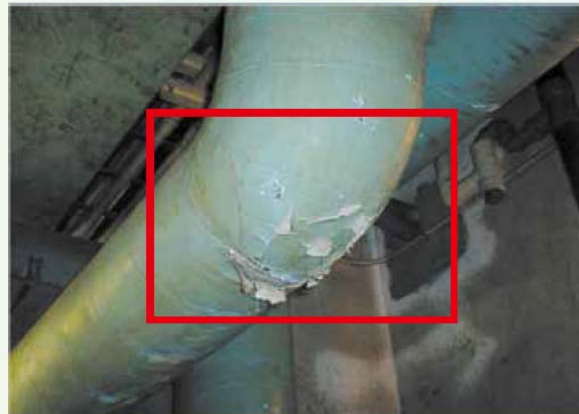
石綿含有保温材（配管曲がり部）
