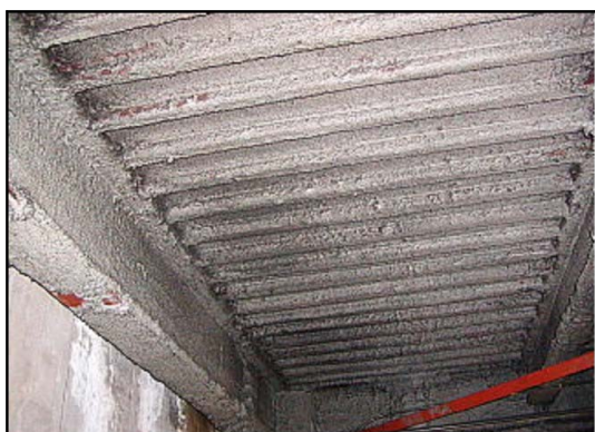
アスベスト含有吹付け材
