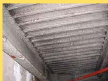
石綿含有吹付けロックウール (鉄骨材の耐火被覆)
