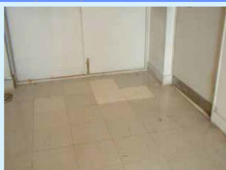
石綿含有ビニール床タイル（床）
