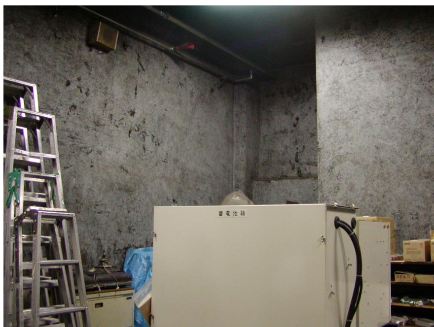
写真 13 全面に繊維のくずれのある吹付け石綿の施工例
