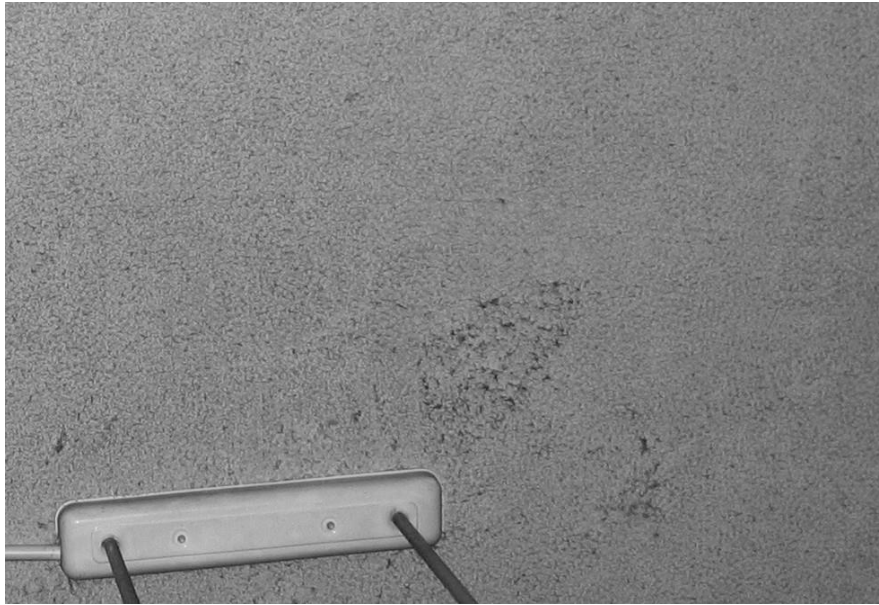
写真 14 局所的な表面の毛羽立ちのある吹付け石綿の例（天井面）
