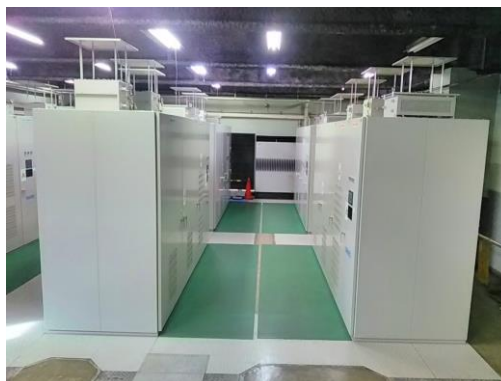
図 2 送水ポンプ用インバータ装置
