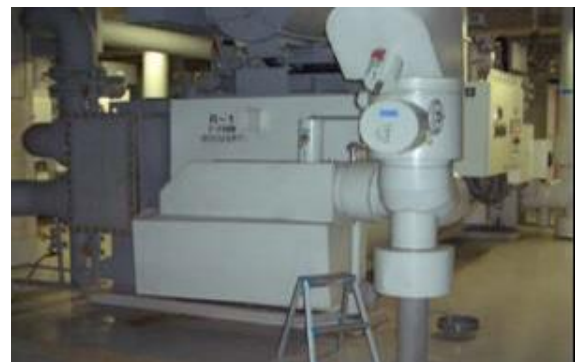
ターボ冷凍機
