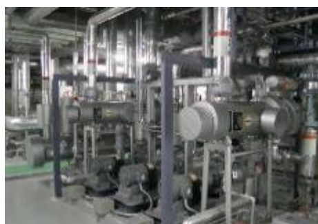
【蒸気配管廻りの保温】
