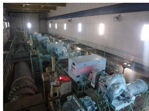
高効率上水道ポンプ
