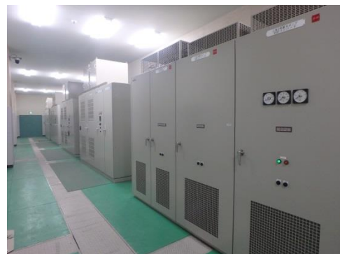
送配水ポンプ用インバータ装置
