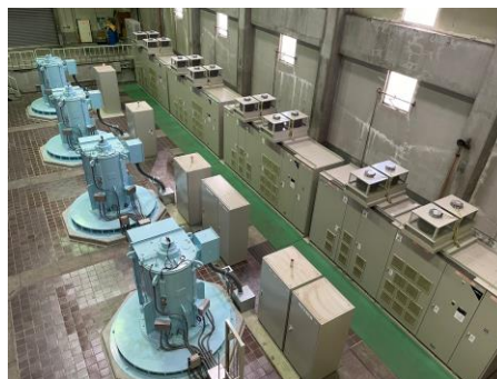
電動機、インバータ制御装置
