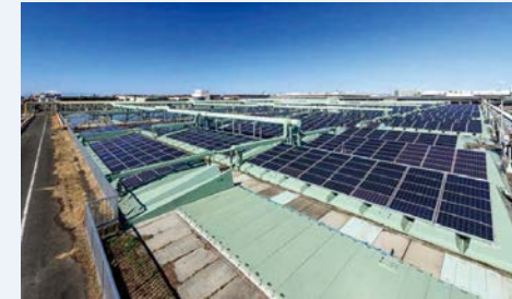
<都内導入事例（太陽光発電）：森ヶ崎水再生センター>
