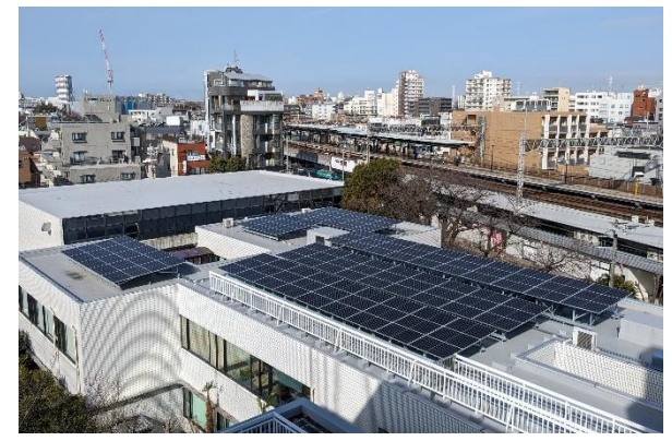
中部総合精神保健福祉センター 太陽光発電設備
